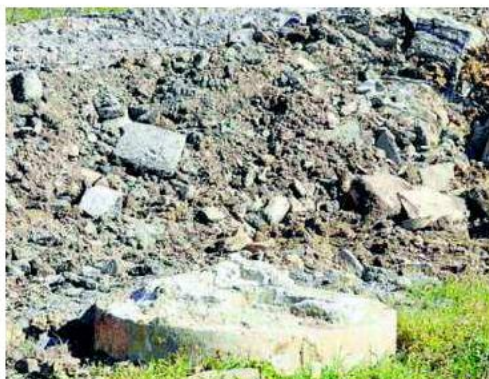
Les remblais déposés à Biriattou par la Société luzienne de travaux publics. PHOTO CADE
