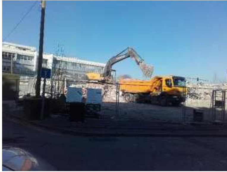
Chargement du camion de déchets. Les gravats viennent d'Anglet, de la démolition du bâtiment Culturel Leclerc sur l'ancienne RN10 à Anglet Bernain.
